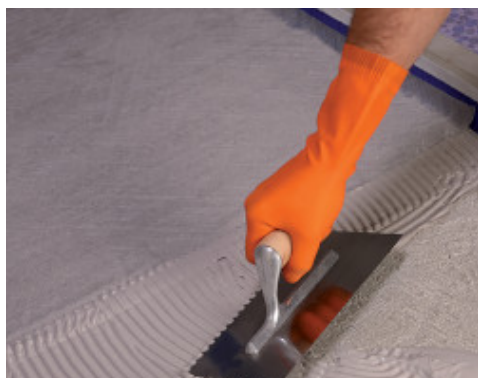
Εφαρμογή της πρώτης στρώσης Monolastic οπλισμένο με Mapetex Sel N σε καινούρια τσιμεντοκονία
