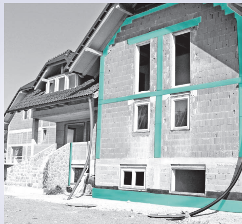
θερμογεφυρών στοιχείων σκυροδέματος
