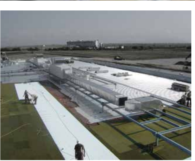
Μεταλλικό δώμα με στεγανοποίηση πολυμερούς μεμβράνης επάνω σε FIBRANgeo BP-70
